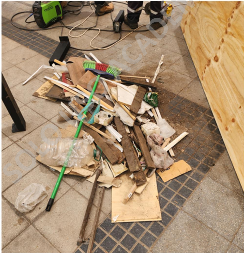
Imagen N°13: Residuos no peligrosos en obra
