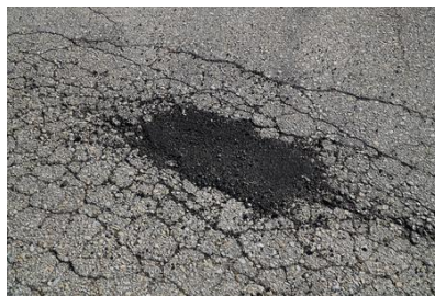
Imagen N°4: Deterioro de la calzada.
