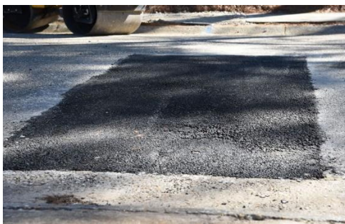
Imagen N°3: Parche de asfalto realizado en una calzada de hormigón.
