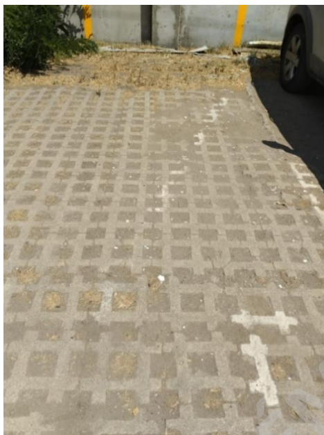
Ilustración 17: Estacionamientos mal demarcados
