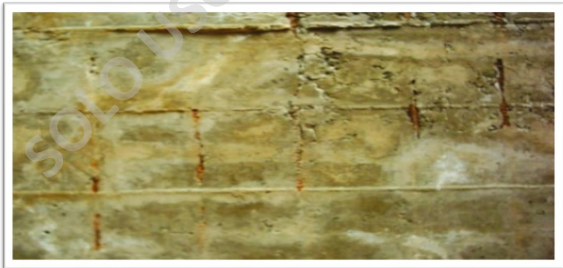
Imagen N°6: Superficie con manchas de oxidación.
