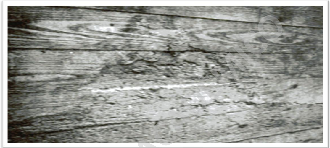
Imagen N°8: Acabado con moldaje estropeado.
