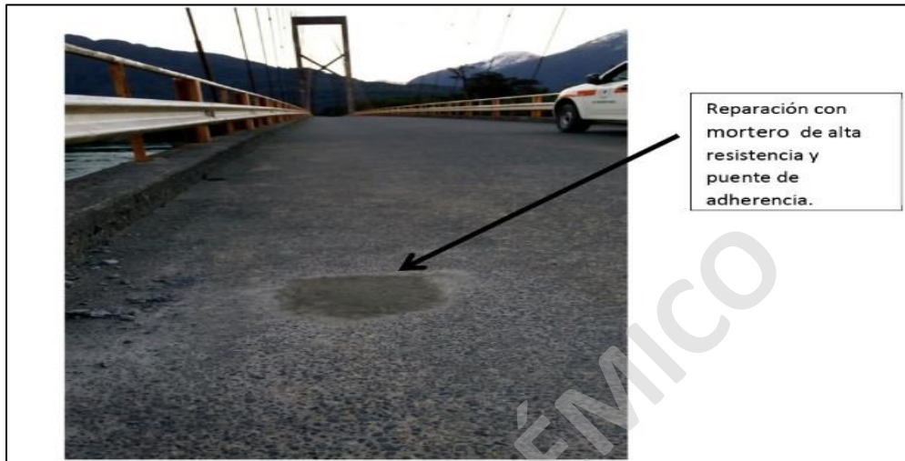
Imagen N° 34: Perforaciones al Tablero del Puente Yelcho
