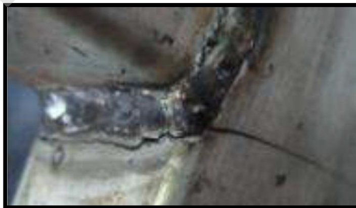
Imagen N46: Fisura en Soldadura – Tramo de torre.
