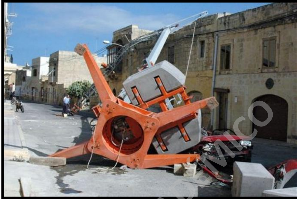
Imagen N°39: Caída Grúa Automontante – Referencia.
