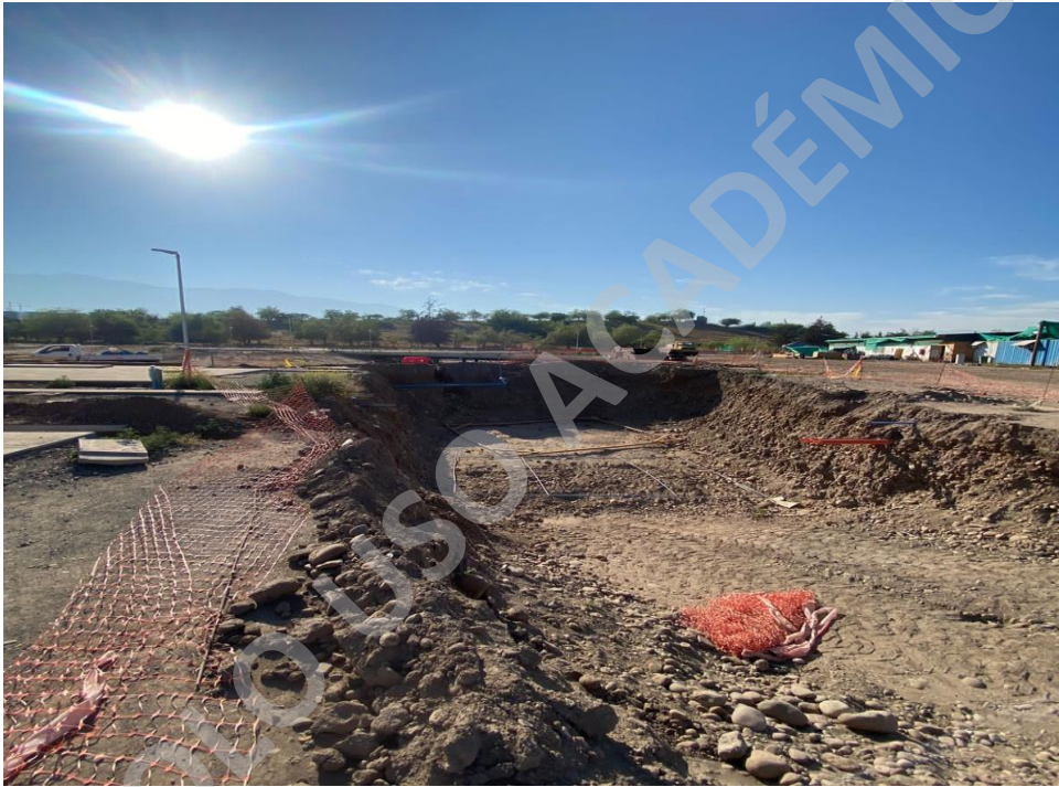
Ilustración 13: Parque República de Brasil. Zona de sala de bombas. Fuente: Fray Jorge, S.A. (2021)
