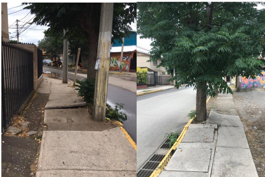
Imagen N° 38: Daño de vereda de hormigón
