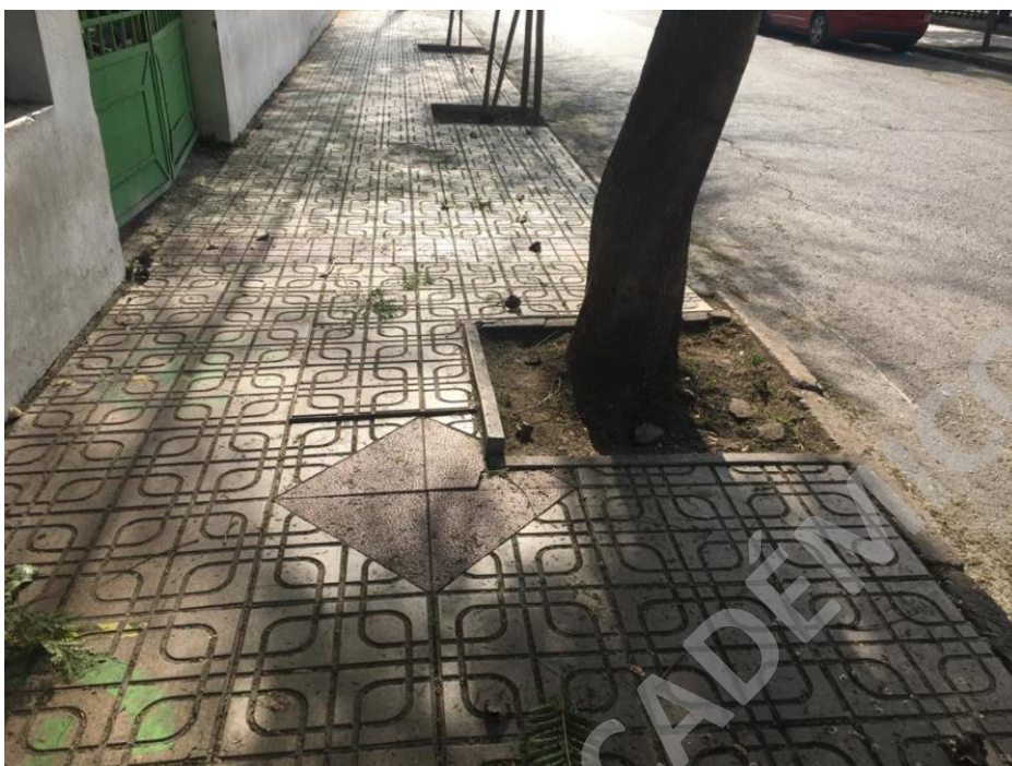
Imagen N° 40: Daño en vereda en baldosas
