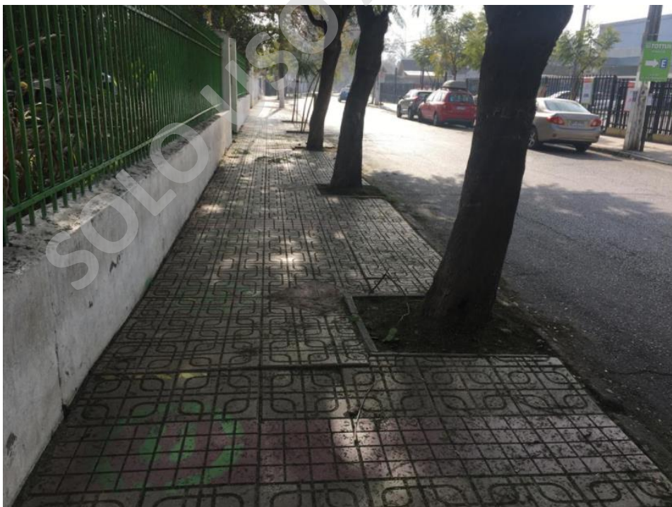
Imagen N° 39: Daño en vereda en baldosas
