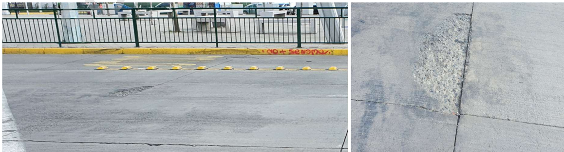
Ilustración 53, Deterioro Calzada Vicuña Mackenna c/ Vespucio Sur (Evidencia Fotográfica Propia).
