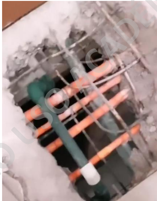
Imagen 12 Imprevisto en Obra Electricidad y Agua Potable
