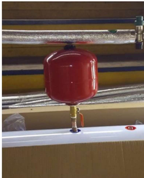
Imagen N°8: Estanque de Expansión.
