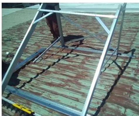
Imagen N°7: Estructura Galvanizada SST 150 lts.
