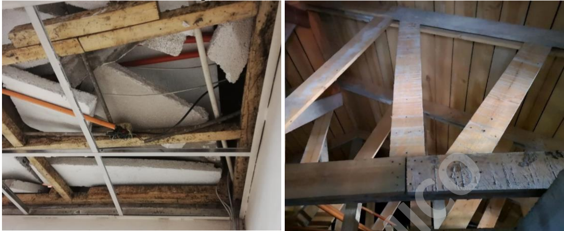
Imagen N° 64: Entretecho primer piso con aislación térmica mal instalada y segundo piso sin aislación térmica.
