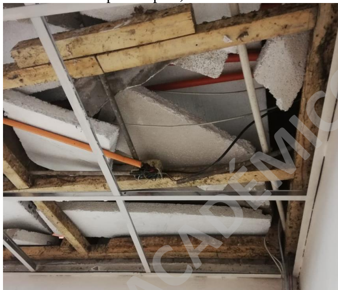
Imagen N° 41: Entretecho primer piso, con aislación térmica mal instalada.
