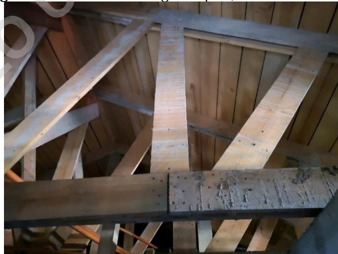
Imagen N° 40: Entretecho segundo piso, sin aislación térmica.
