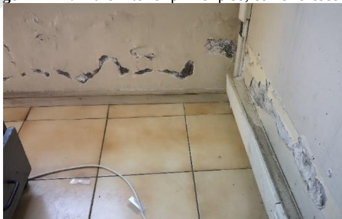
Imagen N° 42: Muro interior primer piso, con eflorescencias.
