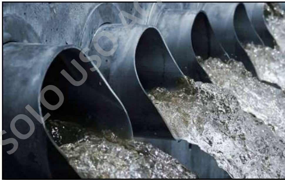
Imagen N° 4: Descarga de Aguas negras
