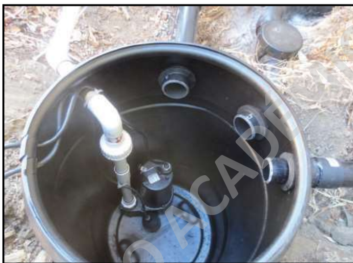
Imagen N° 36: Sistema de Bombeo
