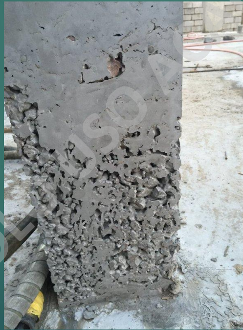
JUNTAS MAL SELLADAS
