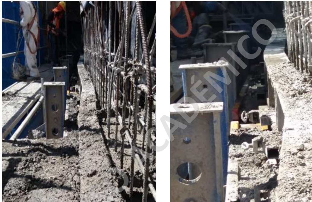
FIG. 9 y 10: Moldaje reventado por falla en sujeción, desplomo de muro. Obtención propia
