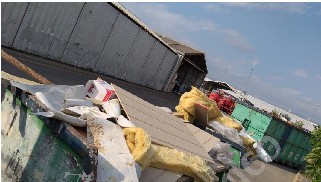
Fuente: TecnoFast (2019) Zona escombros
