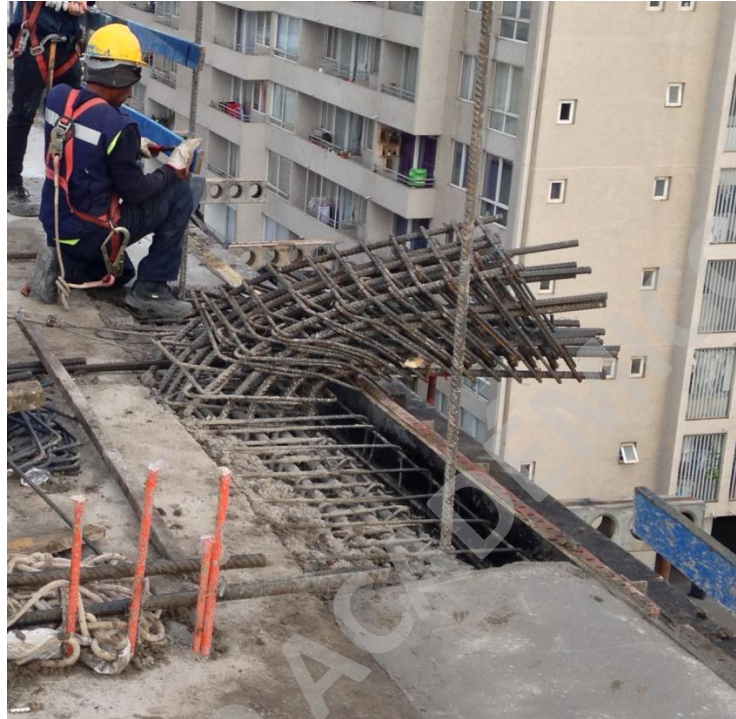
Imagen N° 45: Barras cabezales deformadas, 5° piso – Proyecto Centro Médico Independencia.
