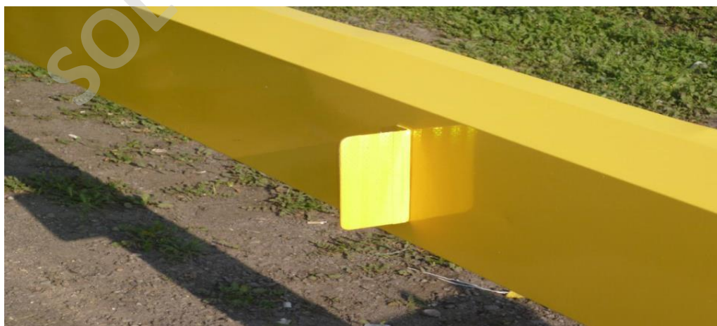
Ilustración 7: PLACA AMARILLA anti-nieve instalada
