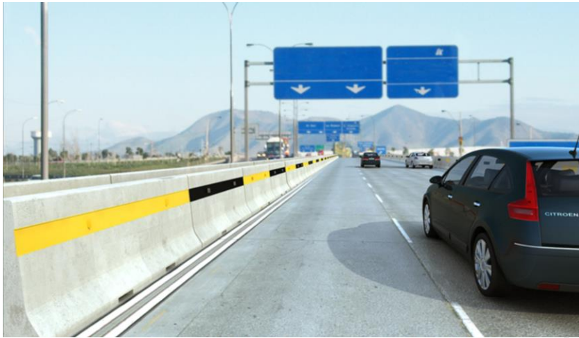
Ilustración 9: PLACA AMARILLA en defensa de hormigón
