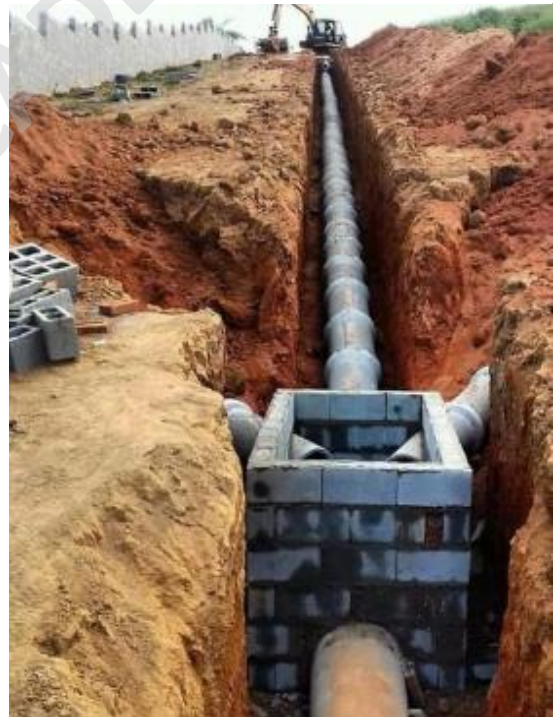
Imagen N°6: Cámara de intersecciones
