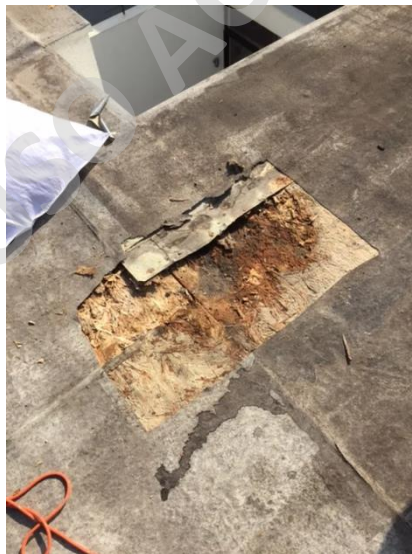
Figura 17. Placa de Osb en mal estado.
