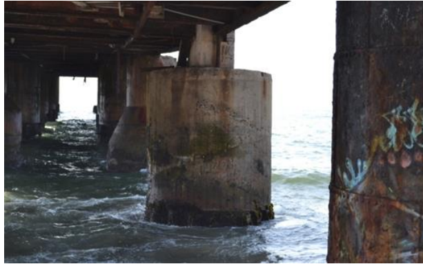
(Fotografía 14) En la actualidad, dos de las pilas presentan en su parte superior una pieza añadida de hormigón la cual se realiza para darle más altura y así nivelar el piso del Muelle. Fuente: Fotografía realizada por la empresa GHD 12.11.11.
