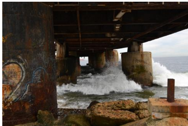
(Fotografía 20) Estado actual de las pilas, la cuales presentan corrosión en su tablestacado. Las primeras pilas han perdido su revestimiento de hormigón quedando el tablestacado a la vista. Fuente: Fotografía realizada por la empresa GHD 12.11.11.
