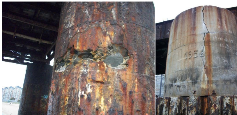
(Fotografía 25) Daños estructura pilas. Fuente: Anexo fotográfico, noviembre 2011
