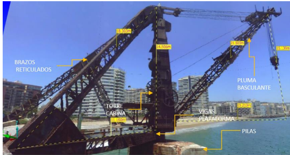
(Figura 19) Partes grúa, elaboración propia, Fuente: Diagnóstico estructural Empresa GHD, diciembre 2012
