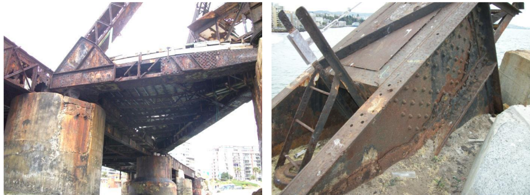
(Fotografía 24) Daños estructura grúa. Fuente: Anexo fotográfico, noviembre 2011
