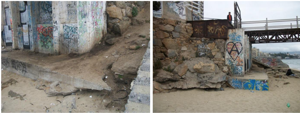
(Fotografía 27) Daños estructura estribo. Fuente: Anexo fotográfico, informe etapa 2 GHD, noviembre 2011
