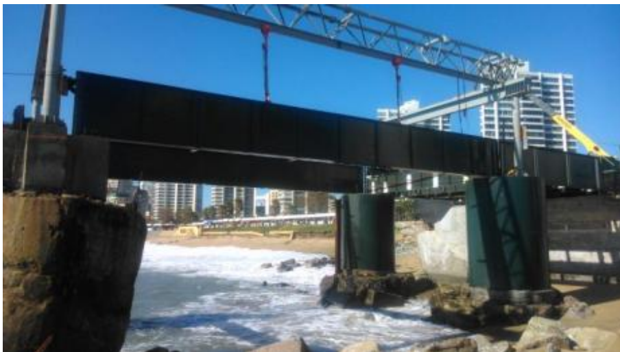
(Fotografía 42) Montaje vigas I al A con viga lanzadora, Fuente: Presentación DOP noviembre 2016
