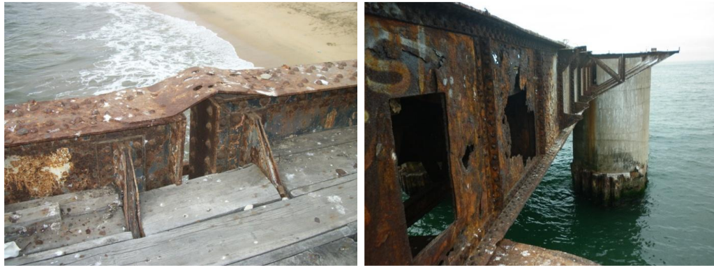
(Fotografía 26) Daños estructura tablero. Fuente: Anexo fotográfico, informe etapa 2 GHD, noviembre 2011
