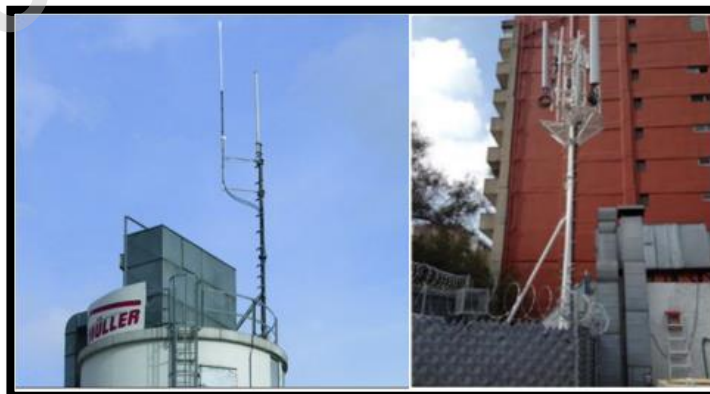
Instalaciones típicas de mástiles Fuente: Google
