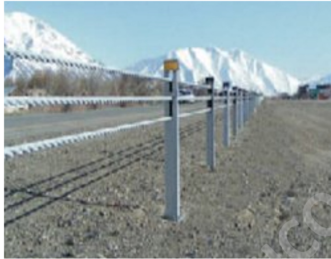
Figura 73. Barreras de cables de Acero Fuente: Obra Global Los Andes, Región de Valparaíso. Año 2016.
