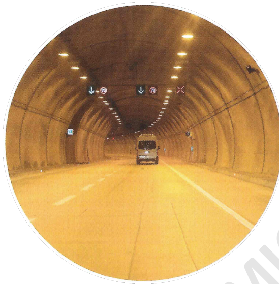
Figura 90. Sistemas de Iluminación Fuente: ISBAK, Architect of Smart City, año 2018
