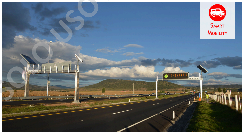
Figura 83. Centro de Control de Tráfico Interurbano Fuente: Sistemas Inteligentes de tráfico SICE, año 2018
