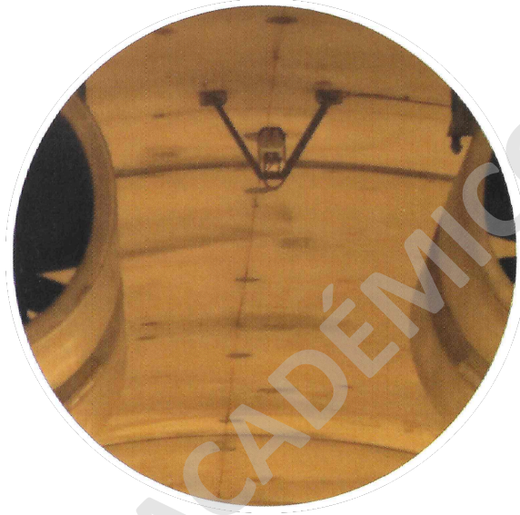
Figura 92. Sistemas de Detección de incendios Fuente: ISBAK, Architect of Smart City, año 2018
