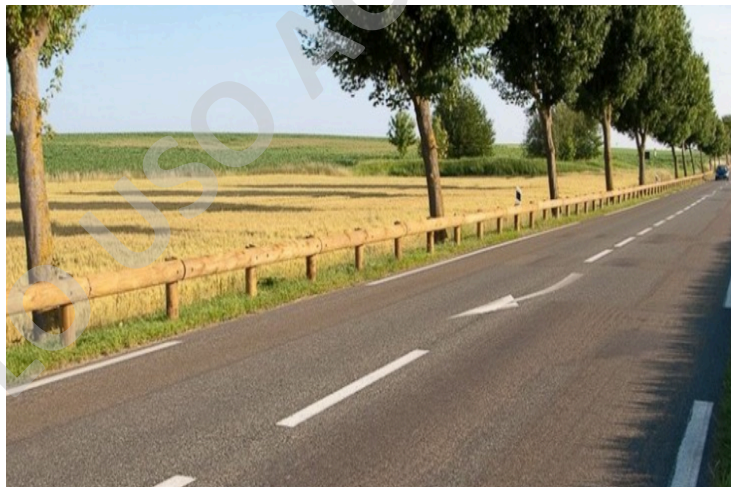
Figura 71. Barreras Mixta metal-madera Fuente: Obra Llanquihue, Región de Los Lagos. Año 2015.
