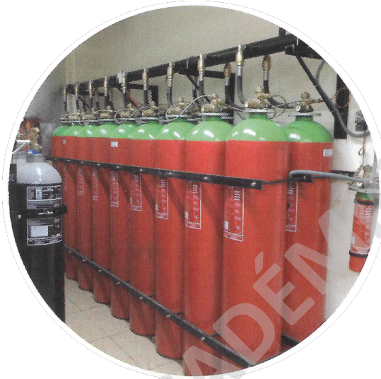
Figura 87. Sistemas de extinción de fuego Fuente: ISBAK, Architect of Smart City, año 2018
