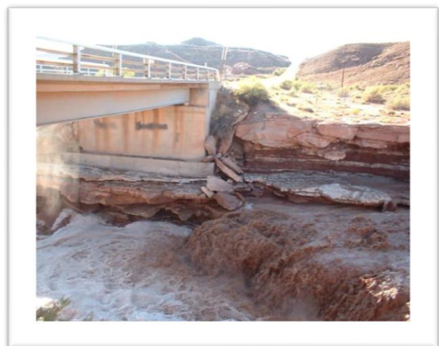
Imagen 12.- Socavación de ladera natural
