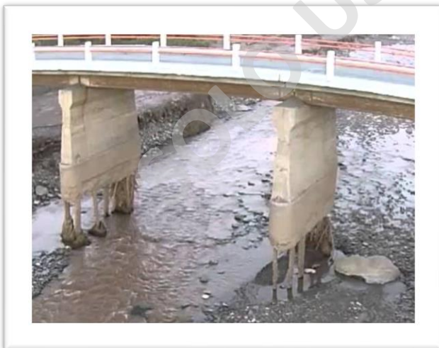
Imagen 13.- Socavación de fundación en puente de río Loa
