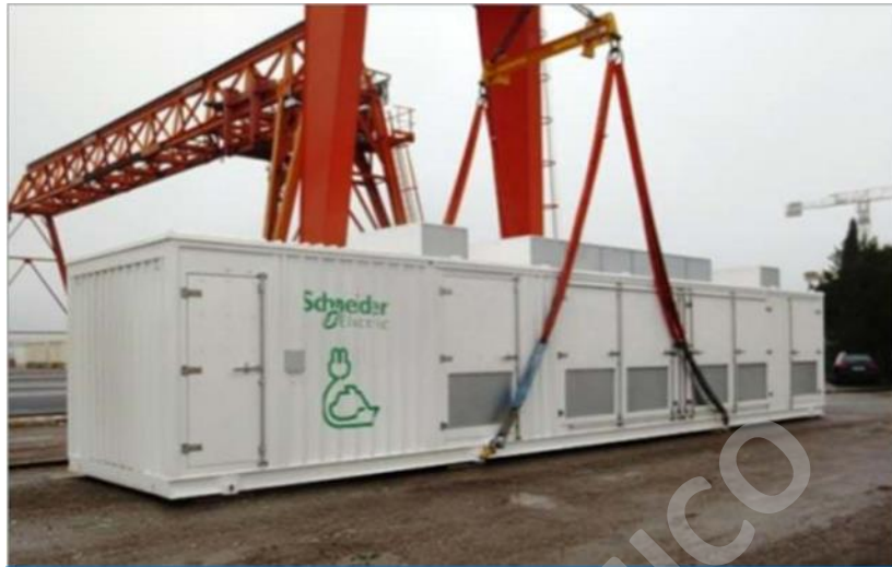
73.- Sistema Modular (ShoreBox) On Shore Power Supply instalado en Bergen, Noruega. Fuente: (Eficiencia Energética en Puertos: Tendencias y Mejores Prácticas, Comisión interamericana de puertos.)
