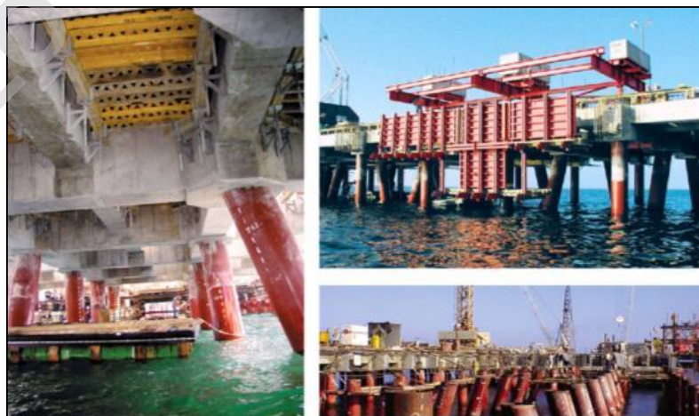
32.- Puerto de Mejillones, Chile, durante la construcción del muelle de carga general.
