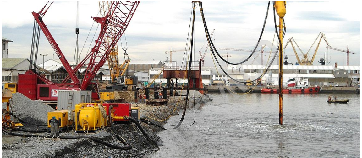
105.- Posicionamiento del equipo, reparación de dársena asmar con columnas de grava "Off Shore", Talcahuano Chile.
