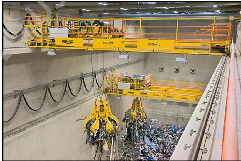
56.- Grúa de proceso en planta de reciclaje.
