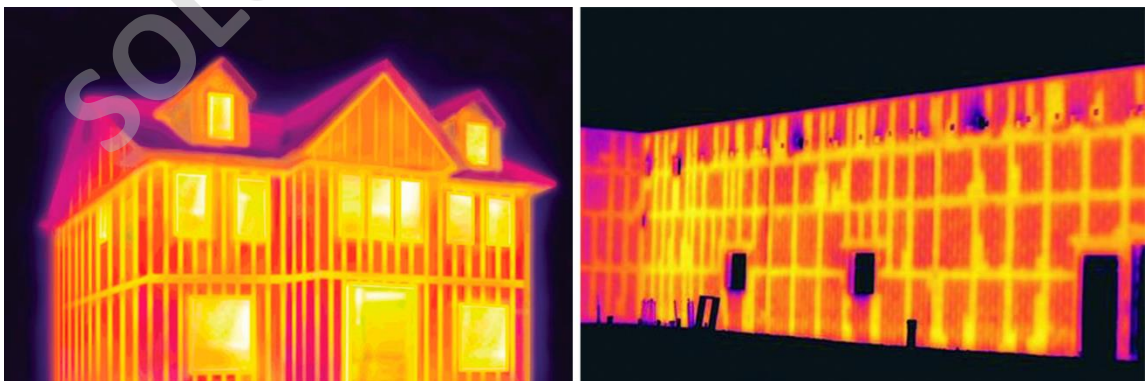
Imagen 6, Fotografías Infrarrojas exteriores de 2 edificaciones, muestran el flujo de energía térmica desde el interior hacia el exterior a través de la estructura de madera de la envolvente. Auscan Home Inspections.
