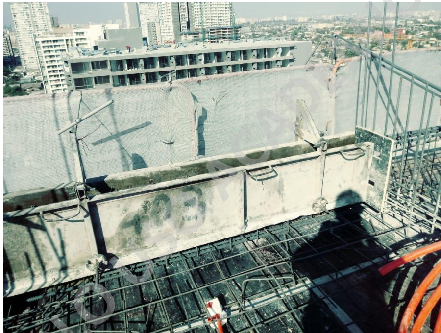
Foto 1.20: Moldaje especial instalado antes de hormigonar. Obra General Amengual Fuente: Elaboración propia
