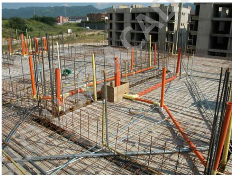
Foto 1.15: Malla inferior e instalaciones. Laguna Centro Fuente: Elaboración propia
