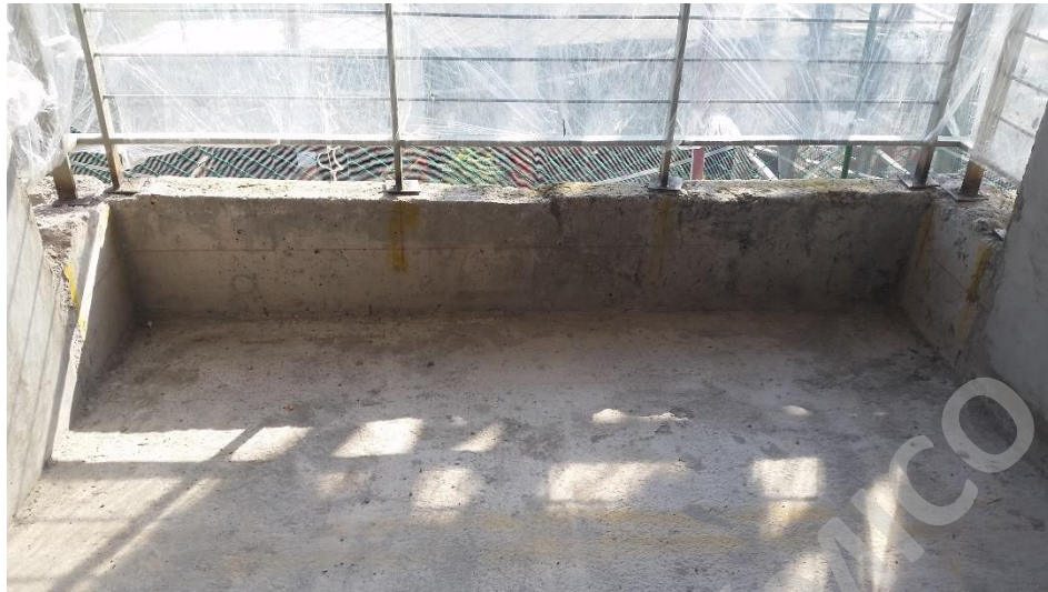
Foto 1.28: Barra mal terminada Fuente: Elaboración propia
