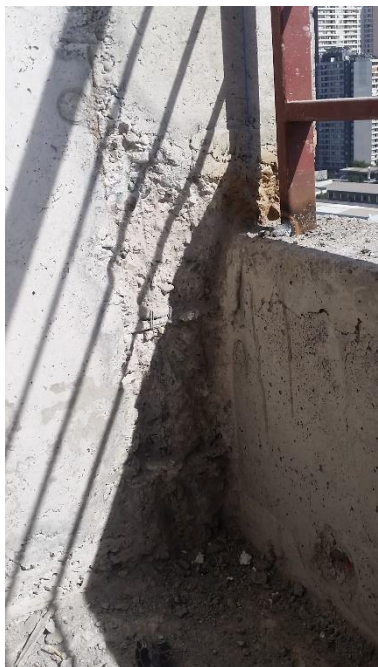
Foto 1.25: Junta viga/muro defectuosa Fuente: Elaboración propia
