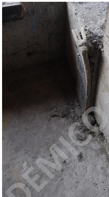
Foto 1.26: Desplome junta viga/muro Fuente: Elaboración propia
