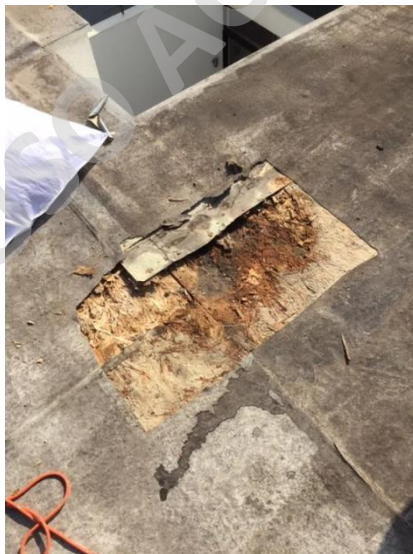
Figura 17. Placa de Osb en mal estado.
