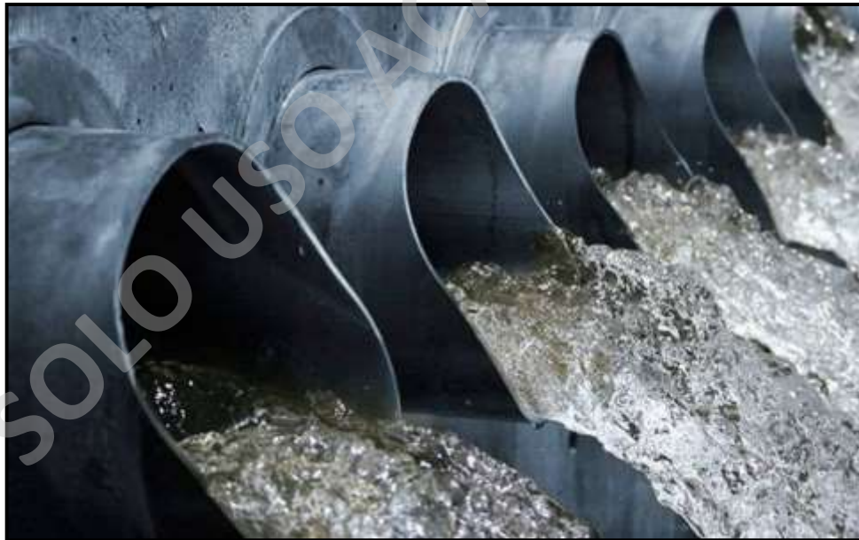
Imagen N° 4: Descarga de Aguas negras
