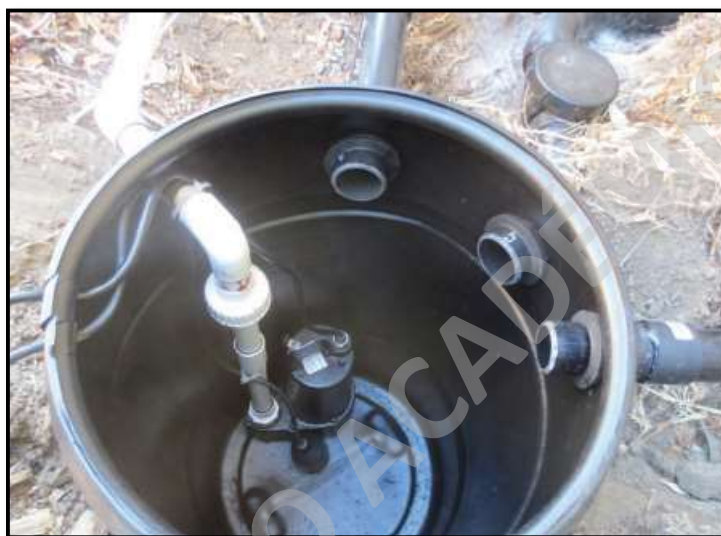
Imagen N° 36: Sistema de Bombeo
