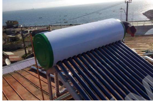
Imagen N°6: Depósito acumulador SST Heat-Pipe 150 lts.
