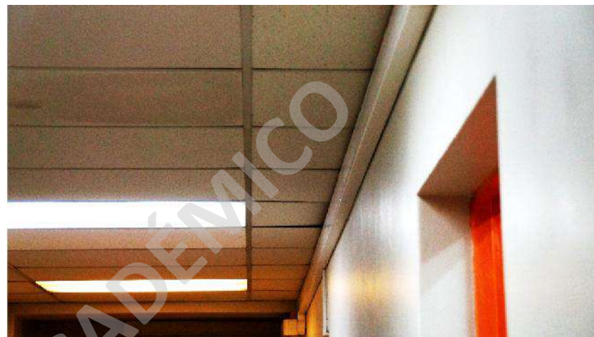
Imagen elaboración propia de cielo falso deteriorado en Hospital San Martín de Quillota.
