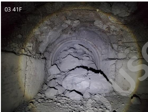
Figura 13: Punto de extracción en sector Panel Reno de zona E.
