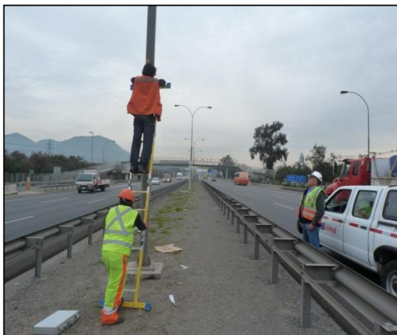
Fijación de equipos a poste de iluminación. (Fuente: Análisis de Impacto acústico, Servicios de acústica ambiental)
