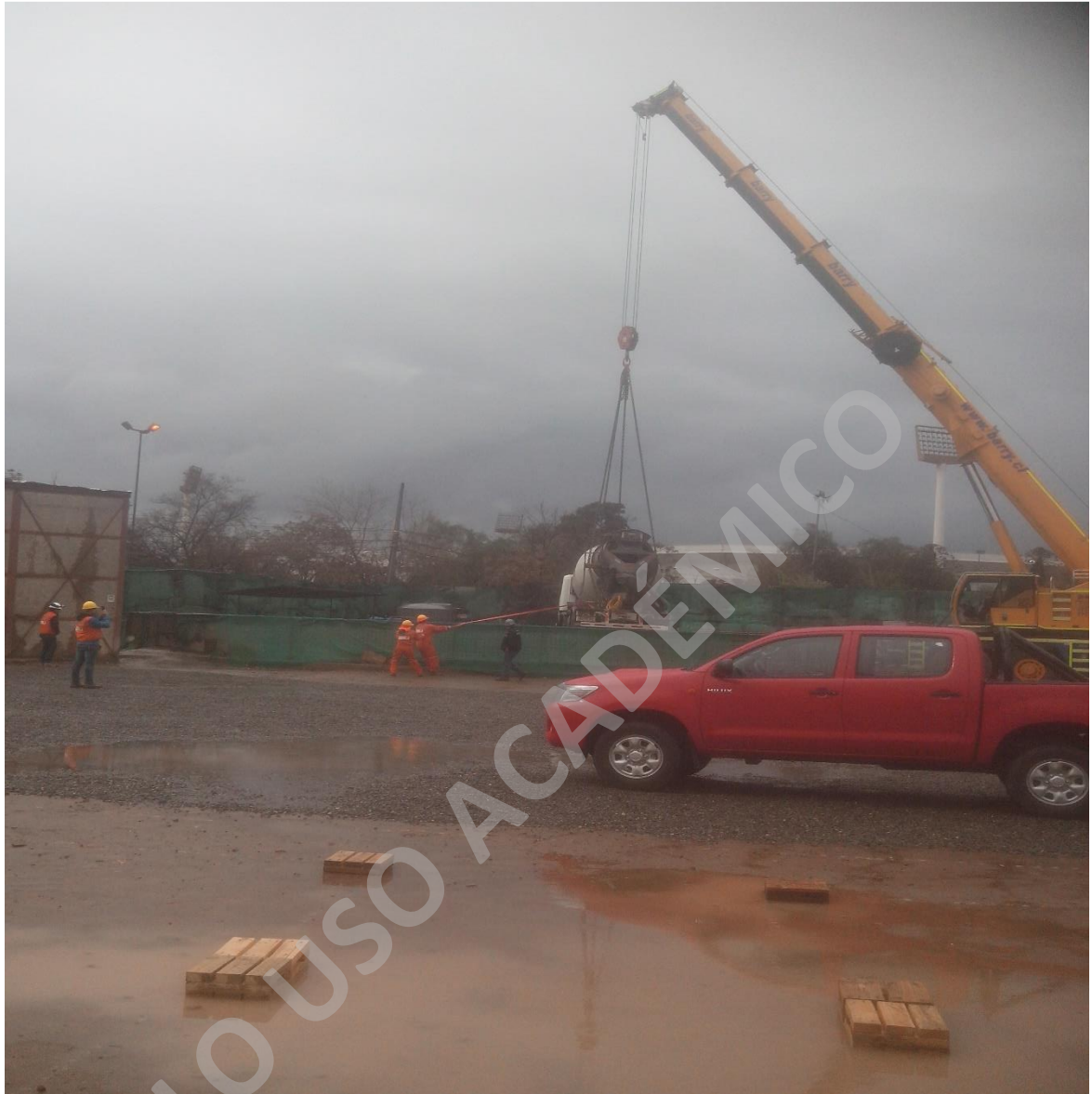
Fotografía 26. Bajando el equipo de camiones de hormigón MIXER por pique MARATHÓN, Agosto 2015.
