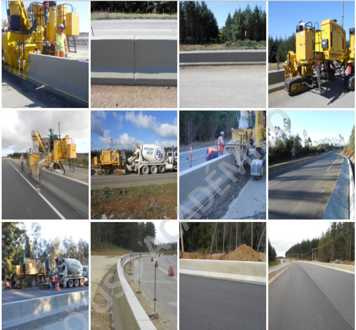
Fotografía 13. Construcción de Barrera; Parapeto; Cuneta; Solera Tipo A con zarpa, proyecto Ruta 160, empresa ejecutora Hormitec.
