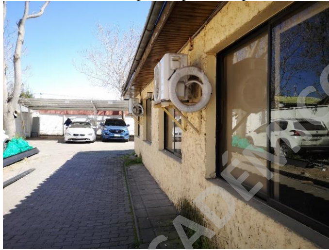
Imagen N° 43: Muro exterior primer piso, con problemas de humedad.
