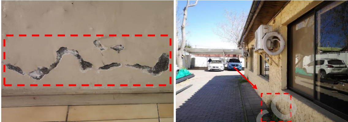
Imagen N° 68: Muro interior con eflorescencias y muro exterior con problemas de humedad.
