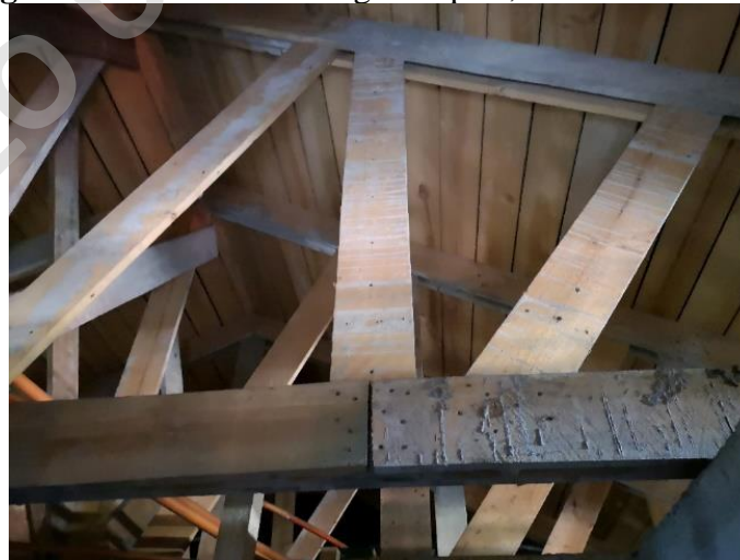
Imagen N° 40: Entretecho segundo piso, sin aislación térmica.
