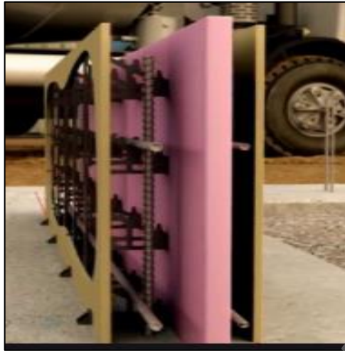
Imagen N° 16. Instalación de planchas de poliuretano expandido, dentro de muros con sistema Spider Tie.
